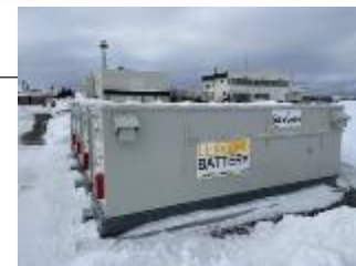
風力発電 蓄電システムコンテナ外観
