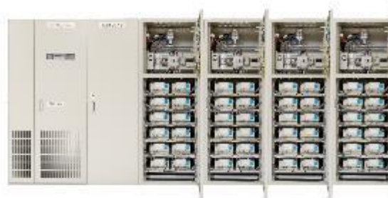
「蓄電システム」
