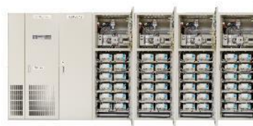
「蓄電システム」
