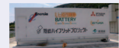
リチウムイオン電池専用コンテナ(リチウムイオン電池システム内蔵)
