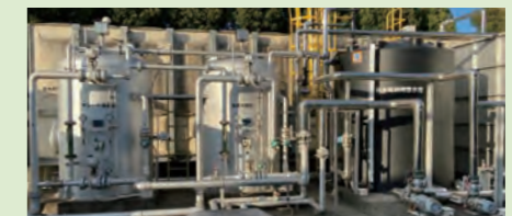
雨水処理設備
