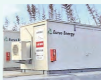
リチウムイオン蓄電池設備外観
