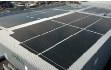
栗東事業所に設置した太陽光発電設備
