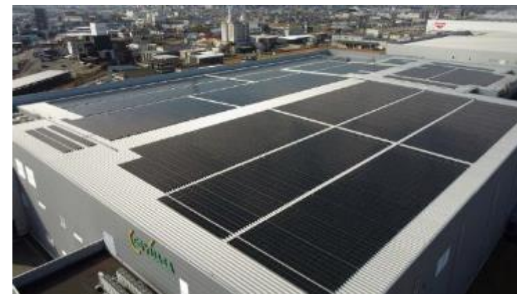
栗東事業所の太陽光発電設備
