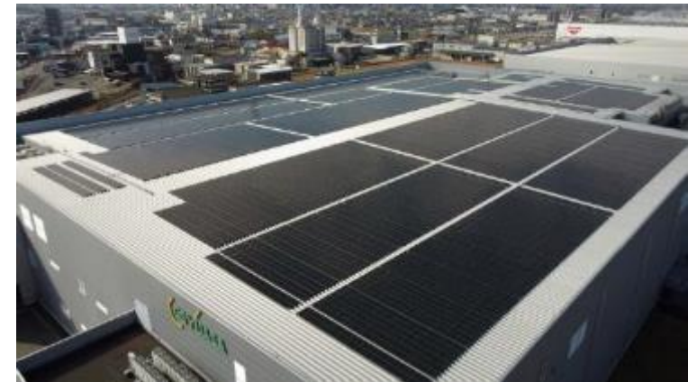
栗東事業所の太陽光発電設備
