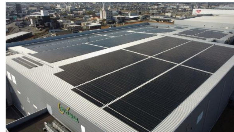
栗東事業所の太陽光発電設備
