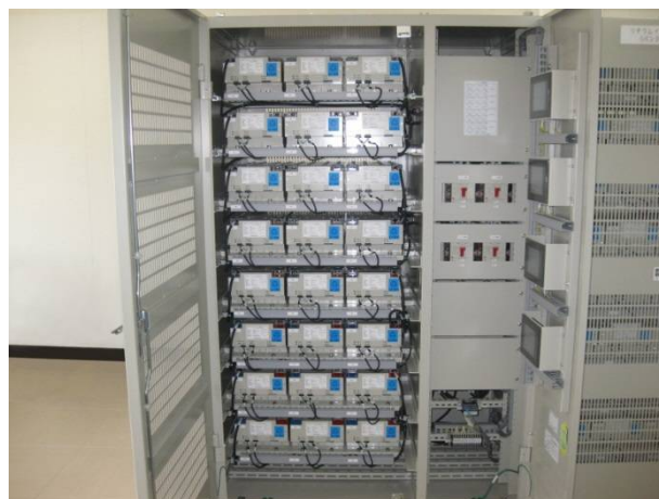
平泉駅に納入されたリチウムイオン蓄電システム (容量:240kWh)
