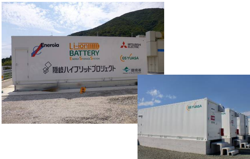
蓄電システム
