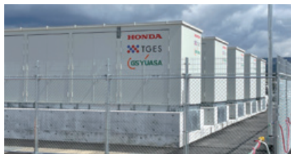
Honda 熊本製作所に設置された リチウムイオン蓄電池設備 (コンテナシステム)
