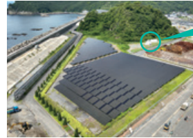
GSユアサ製蓄電池設備
