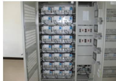
平泉駅に納入した リチウムイオン電池蓄電システム
