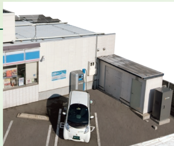
ローソン吉祥院里南店に導入された「PV-EVシステム」
