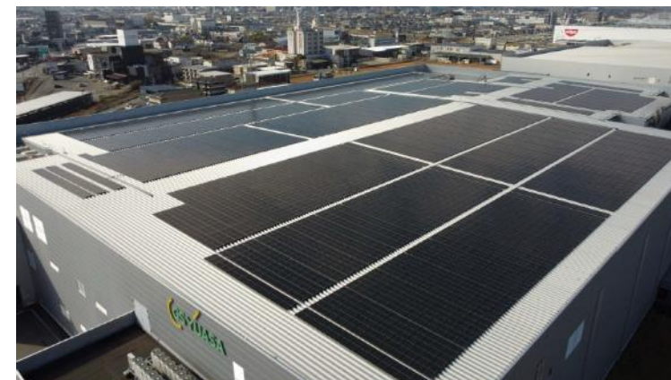
栗東事業所の太陽光発電設備
