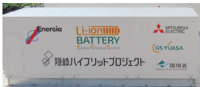
島根県隠岐郡 西ノ島変電所のリチウムイオン電池システム
