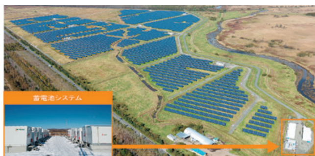
北海道釧路町トリトウシ原野太陽光発電所のリチウムイオン電池システム (写真提供：大林組)
