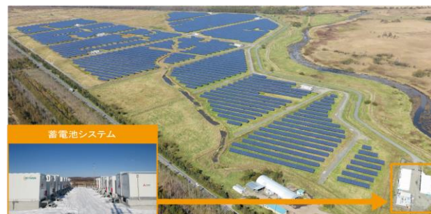
北海道 釧路町トリトウシ原野太陽光発電所のリチウムイオン電池システム
