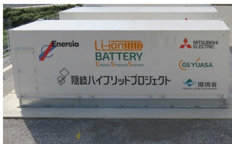
島根県隠岐郡 西ノ島変電所のリチウムイオン電池システム
