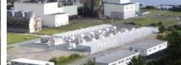
ENEOS 室蘭蓄電所
